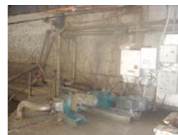
Slika 6. Pumpa za ubacuje materijala u digestor.
