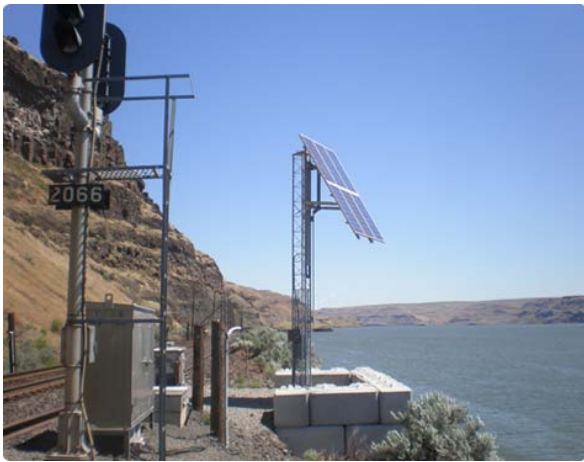
Slika 5. Solarni panel za napajanje pružne signalizacije.
