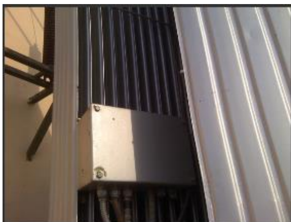
Slika 6. Foto prikaz dela većeg transformatorskog suda
